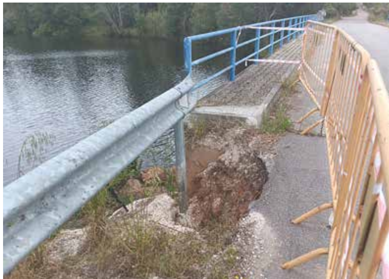
/ A terra desabou junto à ponte que liga as freguesias de Ortiga e Belver
